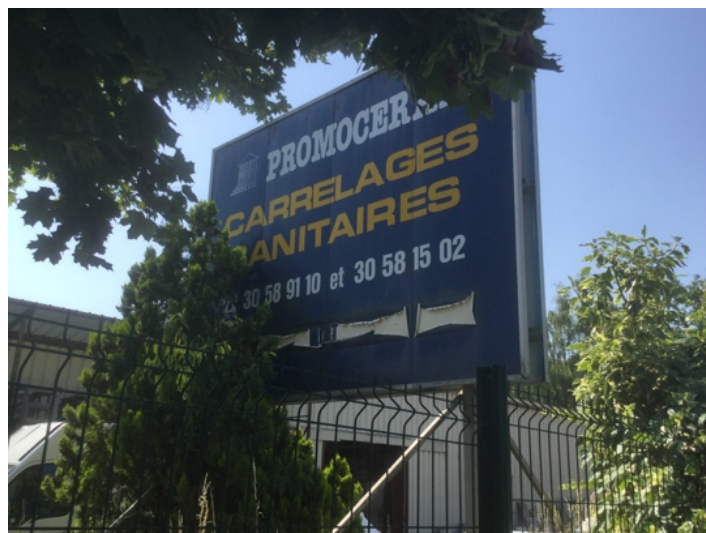
Enseigne scellée au sol ou installée sur le sol en mauvais état d'entretien, Fontenay-le-Fleury, Juillet 2019
